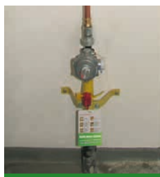
Hauseinführung mit Regelgerät
